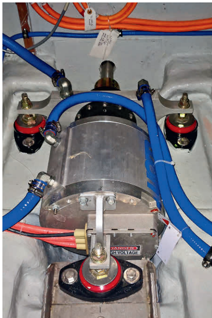
Abbildung 1-3: Der Elektromotor ist deutlich kleiner als ein Verbrenner und kann trotzdem richtig viel Power auf die Welle bringen. [Silent-Yachts]
